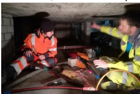
Erklärungen beim Muffen im doppelten Boden einer Trafostation
